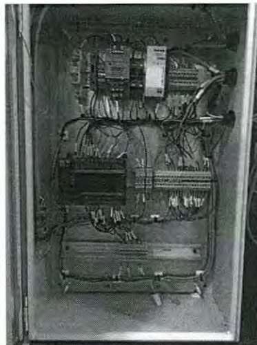
Figura 62. Distribución de cableado eléctrico en gabinete.
