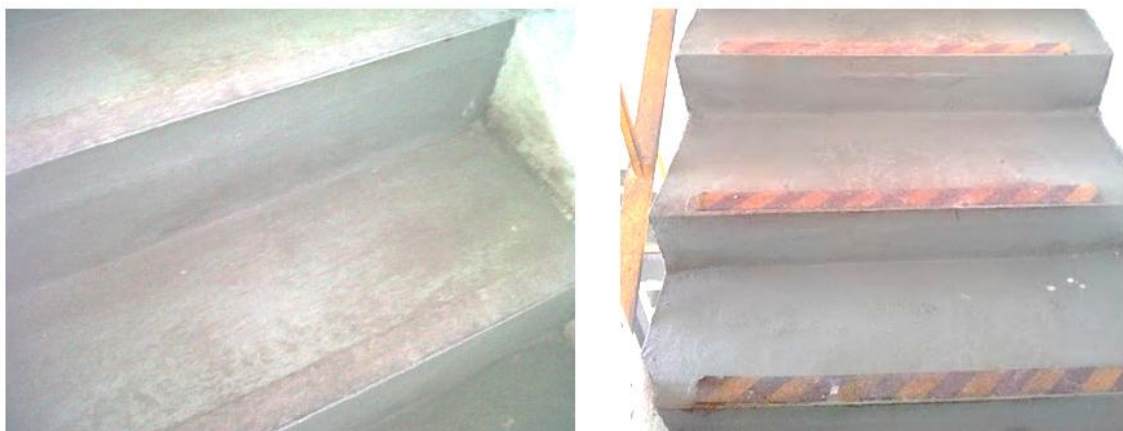
Figura 4.6. Cinta antiderrapante en escaleras.
