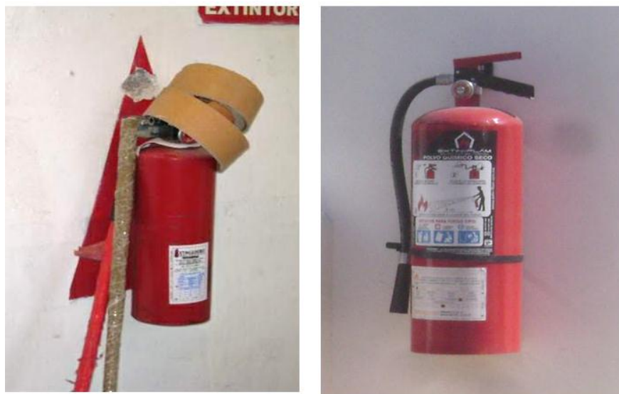
Figura 4.15. Acción correctiva en extintores
