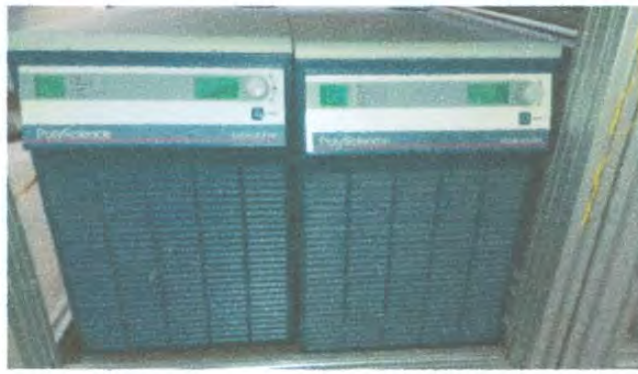
Figura 4.5: Sistema recirculador y enfriador (Chiller).
