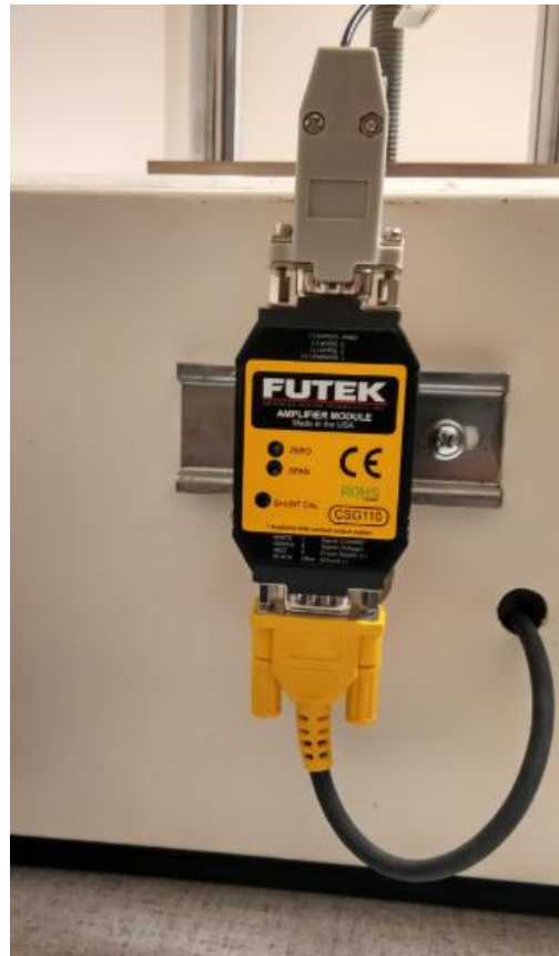
Figura 47. Acondicionador de señales instalado en el instrumento.
