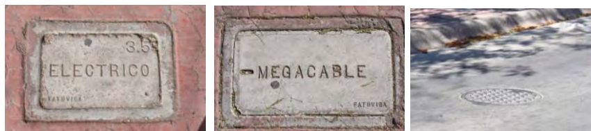
Imagen 38. Infraestructura eléctrica, Voz y datos y Drenaje en Villa de Seris. Fuente. Archivo Propio.
