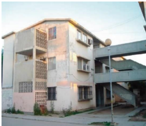
Imagen 52 Fachada posterior con daños aparentes, fuente: archivo personal
