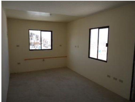
Imagen 43 Fotografía tomada en el interior de la planta baja de una vivienda del modelo Verona, en el área de cocina los acabados son los generales con pintura vinica en la parte de la losa donde se colocará la cocrona e instalaciones, fuente : arch
