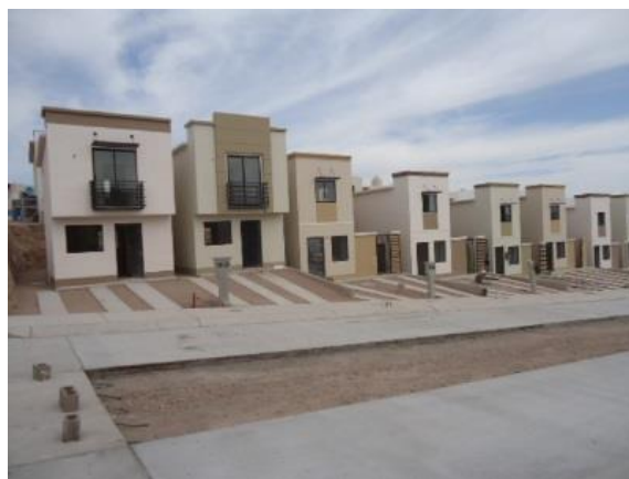
Imagen 44 Fotografía tomada en el exterior donde se aprecia que estaban en la etapa de terminación de vialidades, las cuales se aprecia son a base de concreto armado. fuente: archivo personal
