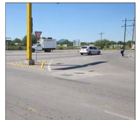
Foto 6: Detalle de baches sobre la Carretera Federal 14.
