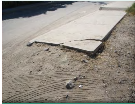
Imagen 6: Acera en mal estado
