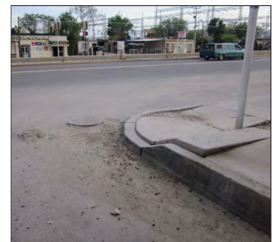
Foto 6: Detalle de alcantarilla y rampa de discapacitados en mal estado, sobre la calle San Pedro.
