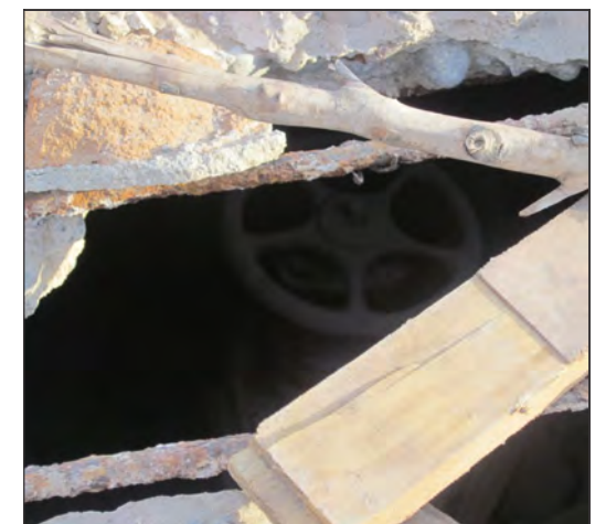
Foto 6: Detalle de irregularidades sobre la calle Revolución.
