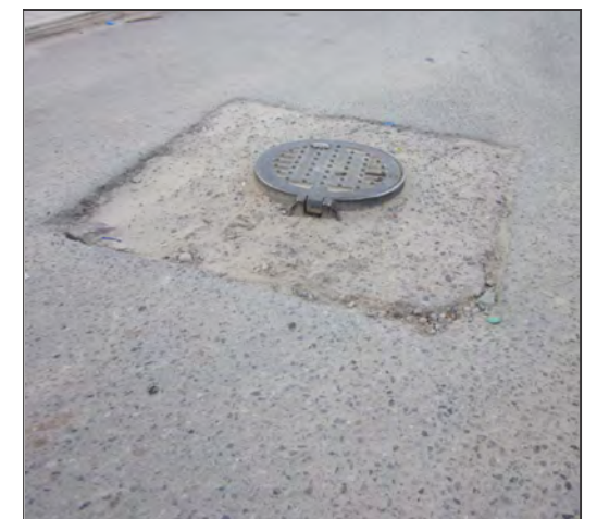
Foto 6: Detalle de alcantarilla en mal estado, sobre la calle Revolución.
