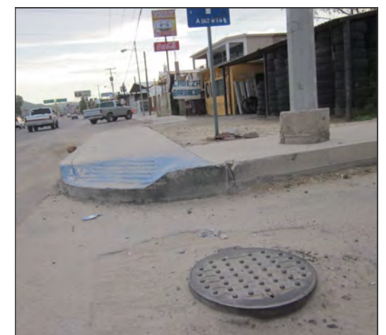
Foto 6: Detalle de alcantarilla y rampa de discapacitados en mal estado.
