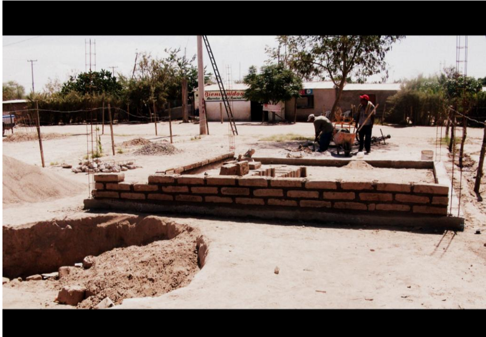
Fig.2.14.- Elaboración de vivienda de adobe, con refuerzo de concreto y acero. Foto: Nahuel Moreno.
