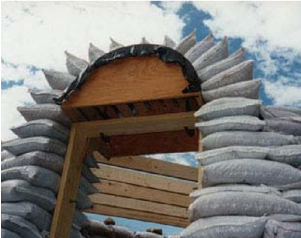
Fig.3.53.-La utilización de cimbra con formas circulares, nos permite moldear y colocar de manera fácil los sacos y así librar los vanos que sean requeridos (Foto: SDA*)
