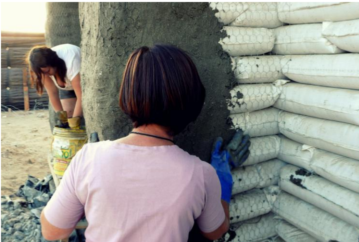
Fig.3.60.-. Revestimiento de muros exteriores e interiores con mortero de Cal: Cemento: Arena. Para brindar una mayor estabilidad al muro. (Foto: Autor*)
