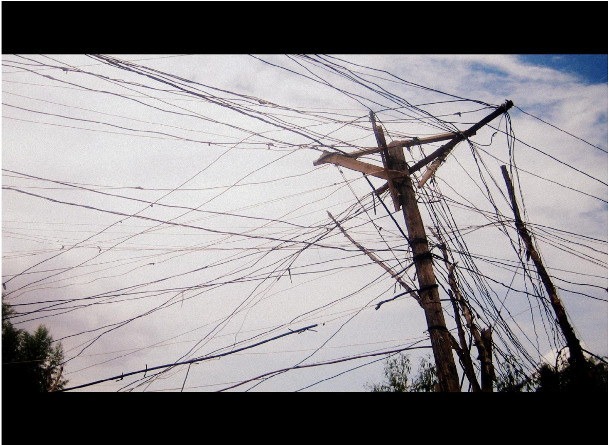
Fig.2.7- Se observa poste eléctrico elaborado por la misma comunidad y sobresaturado de líneas, que representan un peligro para la comunidad, los niños en particular. Foto: Autor*
