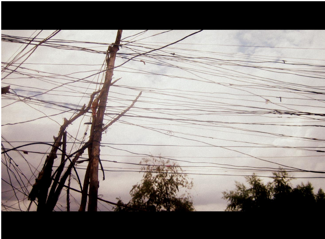
Fig.2.6- Observe la mala condición de los improvisados postes, que no cumplen con la más mínima norma de seguridad. Foto: Roberto Michelena
