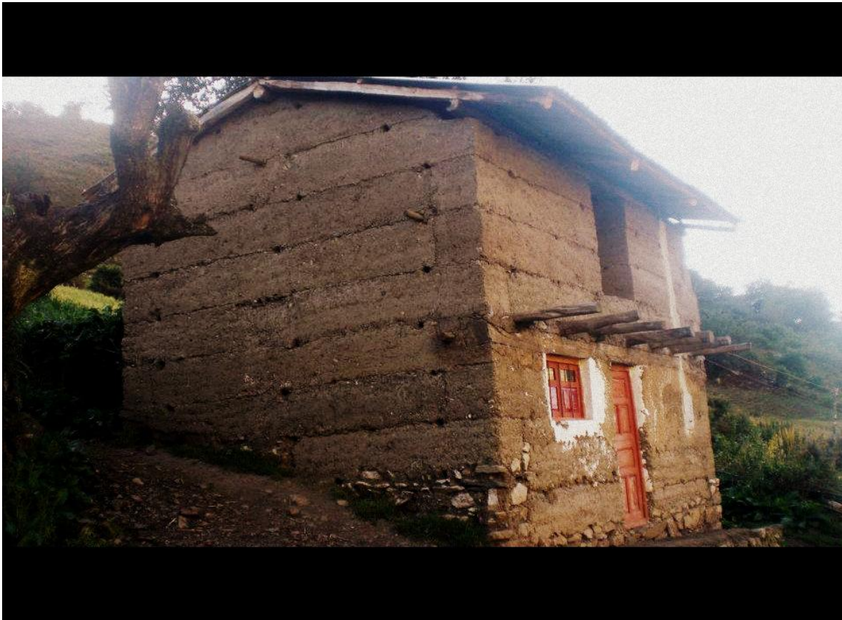
Fig. 3.34.- Vivienda en zona rural de la sierra peruana, elaborada con tapial y cimientos de mampostería. Junto con sistema de adobe son los sistemas constructivos más utilizados en esta zona peruana para la edificación de viviendas .Fuente propia.
