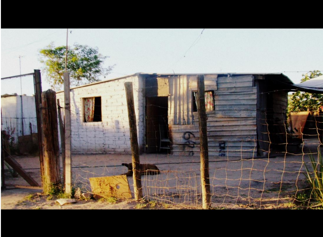
Fig.2.13.- Vivienda elaborada con lámina; mal aislante ante las condiciones extremas del sitio.
