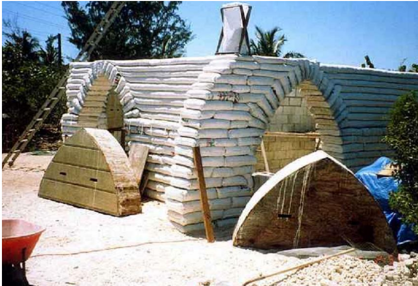
Fig.3.54.-.colocacion de sacos en forma de arco apuntado con la ayuda de cimbra, lo que permite crear grandes vanos de cualquier forma y con gran facilidad.
