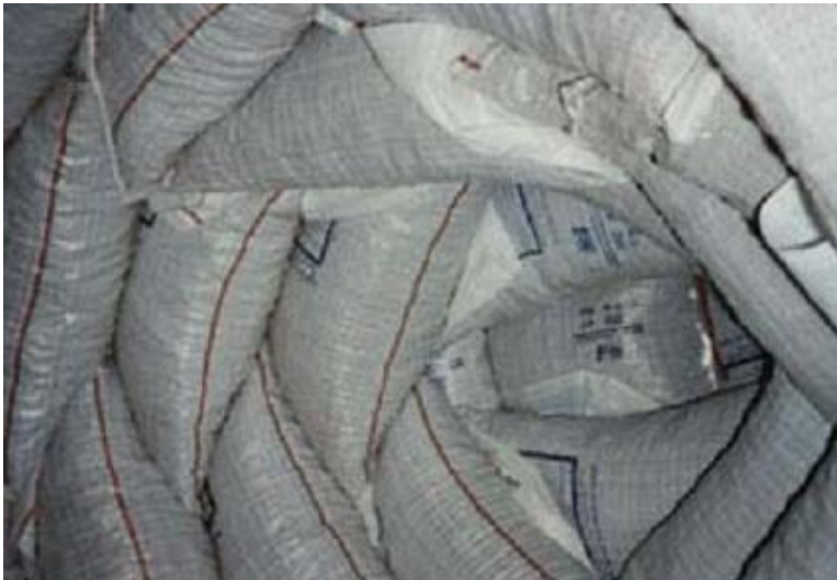
Fig.3.58.-.Se muestra la culminación de una cubierta de forma de bóveda elaborada solamente con sacos de tierra. (CDA*)
