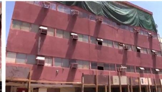
IMG 04 - Hotel de Anza en estado deplorable - El Imparcial
