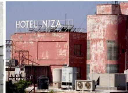
IMG 03 - Edificio en abandono - El Imparcial
