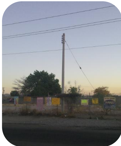
Fotografía 10 Servicio de electricidad. Fuente: Elaboración propia
