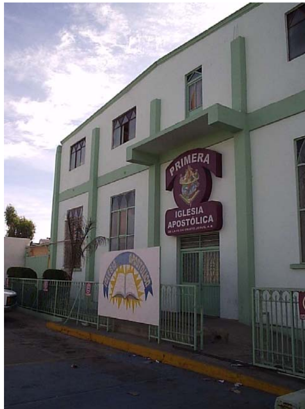
1.7 Acercamiento de la entrada. Se puede observar que, aunque el área cuenta con rampas, estas no tienen las medidas especificadas en el reglamento de construcción en la sección de acceso para personas con discapacidad.
