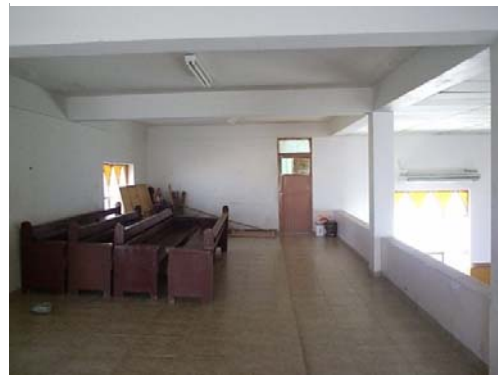
1.4 Área de mezzanine. Como se observa, ha caído en desuso debido a las malas condiciones de isotérmica y acústica que presenta.
