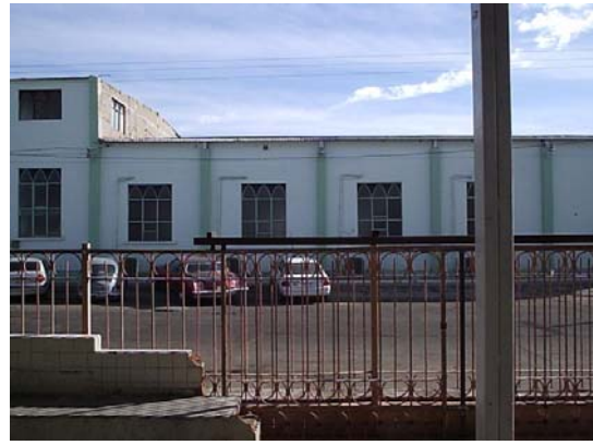
1.6 Vista norte del edificio, donde se puede apreciar el mal estado de las áreas circundantes.
