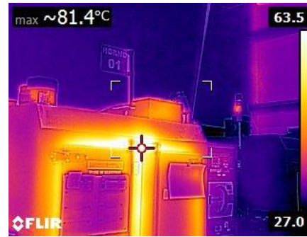
Figura 17. Pérdidas de calor en hornos (Furukawa).
