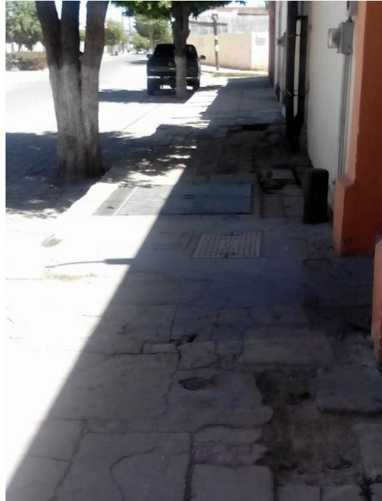
Figura 30: Banqueta en mal estado
