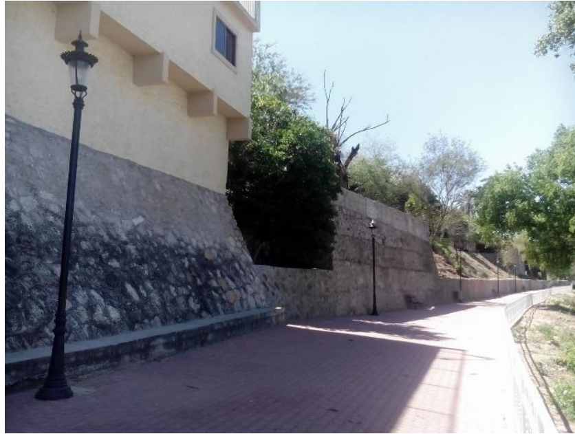
Figura 20: Vista al muro de contención en el paseo del Malecón del Río Fuerte
