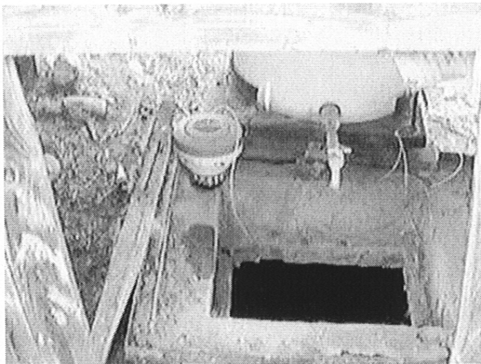
Figura 16 Sistema de cloración con líquido y con pastilla.
