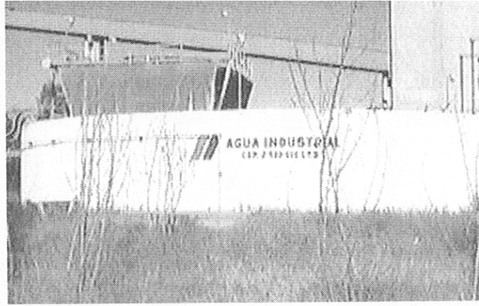
Figura 19 Torre de enfriamiento del sistema de agua industrial
