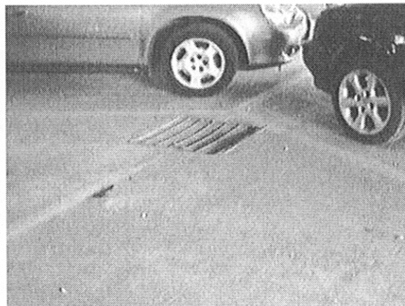
Figura 9 Drenaje en estacionamiento bajo oficinas generales.
