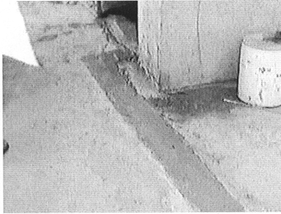
Figura 8 Canaleta y descarga clausuradas con cemento.
