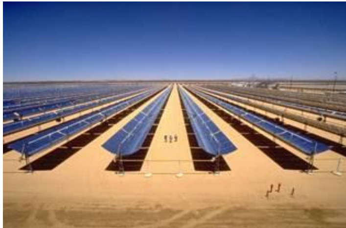
Figura 2.24. Concentradores de canal parabólico de la planta Sistema de Generación Eléctrica Solar, (SGES), California, EUA.
