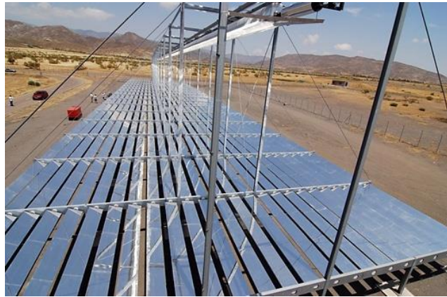
Figura 2.25. Concentradores de Fresnel lineal FRESDEMO (visto desde el receptor), en la Plataforma Solar de Almería, España.
