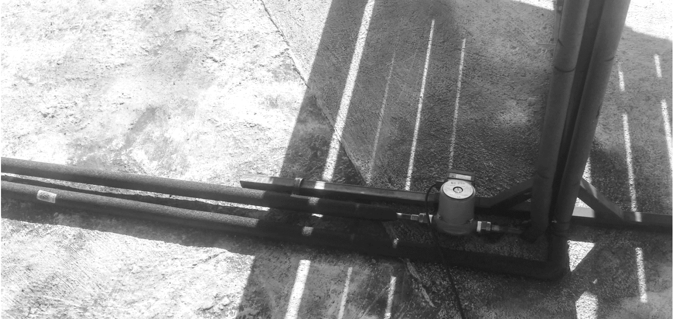
Figura 2. Tubería de transporte y sistema de bombeo.
