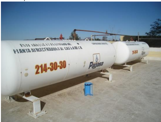
2 Tanques (5000 Lt C/u) Gas LP, Terraza de Primer Piso (Oeste), Explosión-Incendio.
