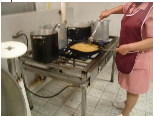
Estufas, Cocina, Explosión-Incendio.
