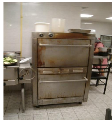
Horno de Gas LP, Cocina, Explosión-Incendio.
