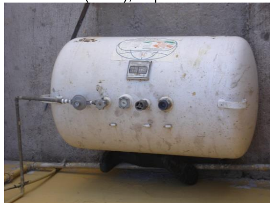
1 Tanque de Gas LP chico, Junto a Depósito de RPBI (Noreste), Explosión-Incendio.
