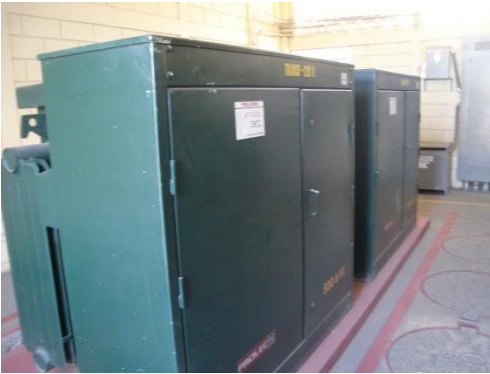
Tranformador, Cto. Maq. HIMES, Explosión.
