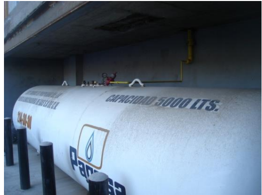
1 (5000 Lts) Taque de Gas LP, Junto a Lavandería (norte), Explosión-incendio.
