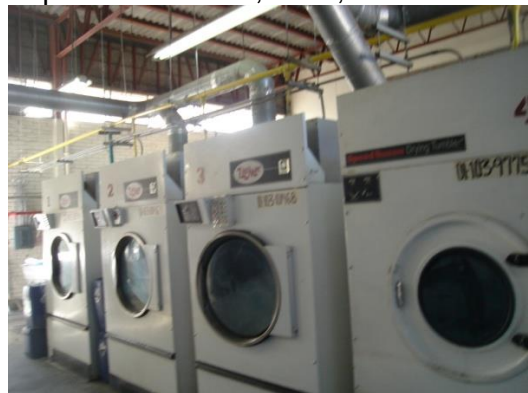
Secadoras de Ropa, Lavandería, Explosión-Incendio.
