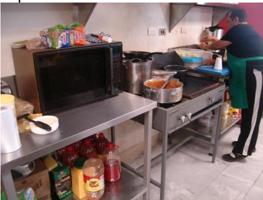
Estufa-Horno de MO, Cafetería HIES, incendio-explosión.
