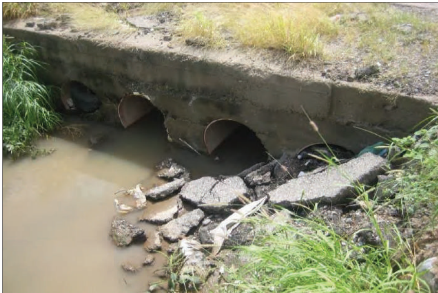
Foto 2. Avenida Xólotl y Lauro Gálvez, drenes de alcantarillado tapados por escombros y una llanta
