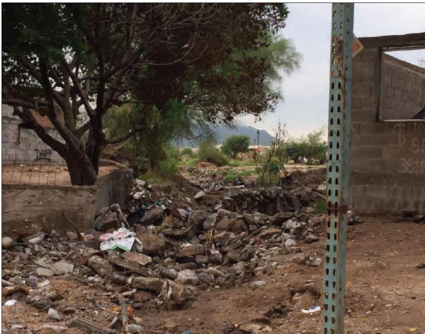
Foto 6. Calle Lirio, cauce principal obstruido por escombros
