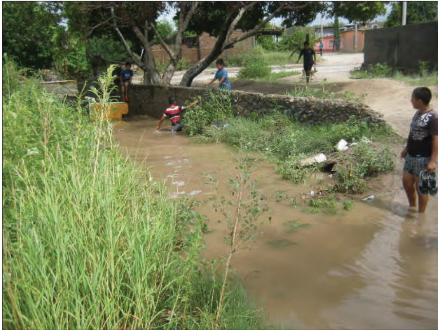
Foto 5. Avenida Ardillas, se puede observar la acumulación de agua debido a un taponamiento
