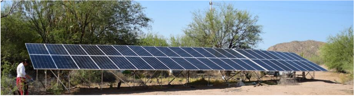
Figura 8. Sistema FV de 17.5 kWp en pozo de El Desemboque, Sonora.
