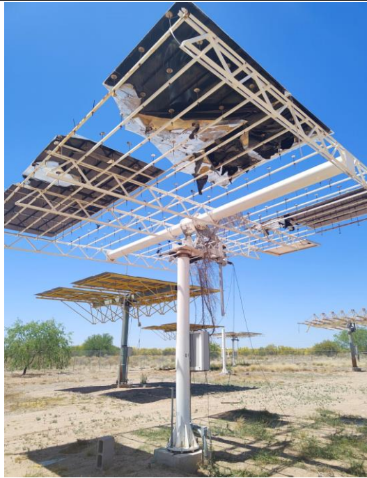
Figura 6. Daños a la estructura de un heliostato por el viento en el CEToC.
